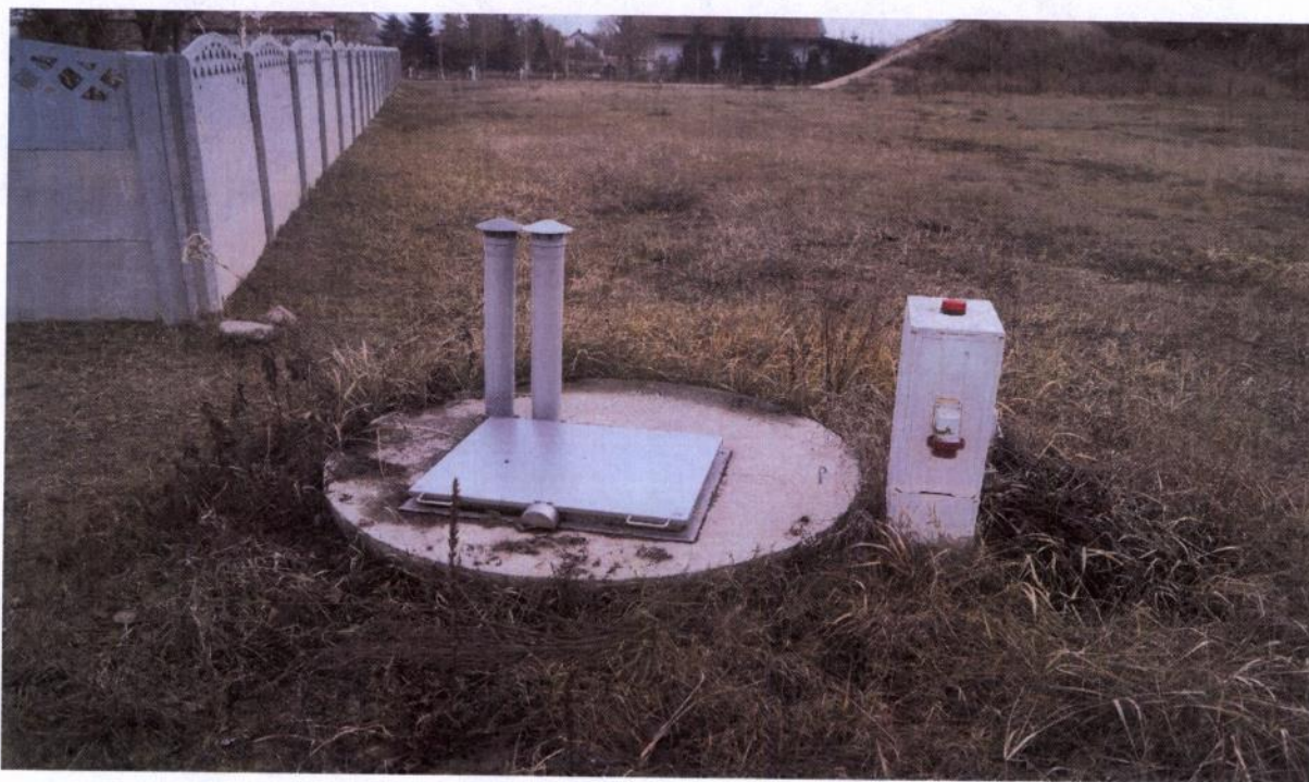
Rysunek 39. Przepompownia Nr 3 pompująca ścieki do oczyszczalni źródło: opracowanie własne
