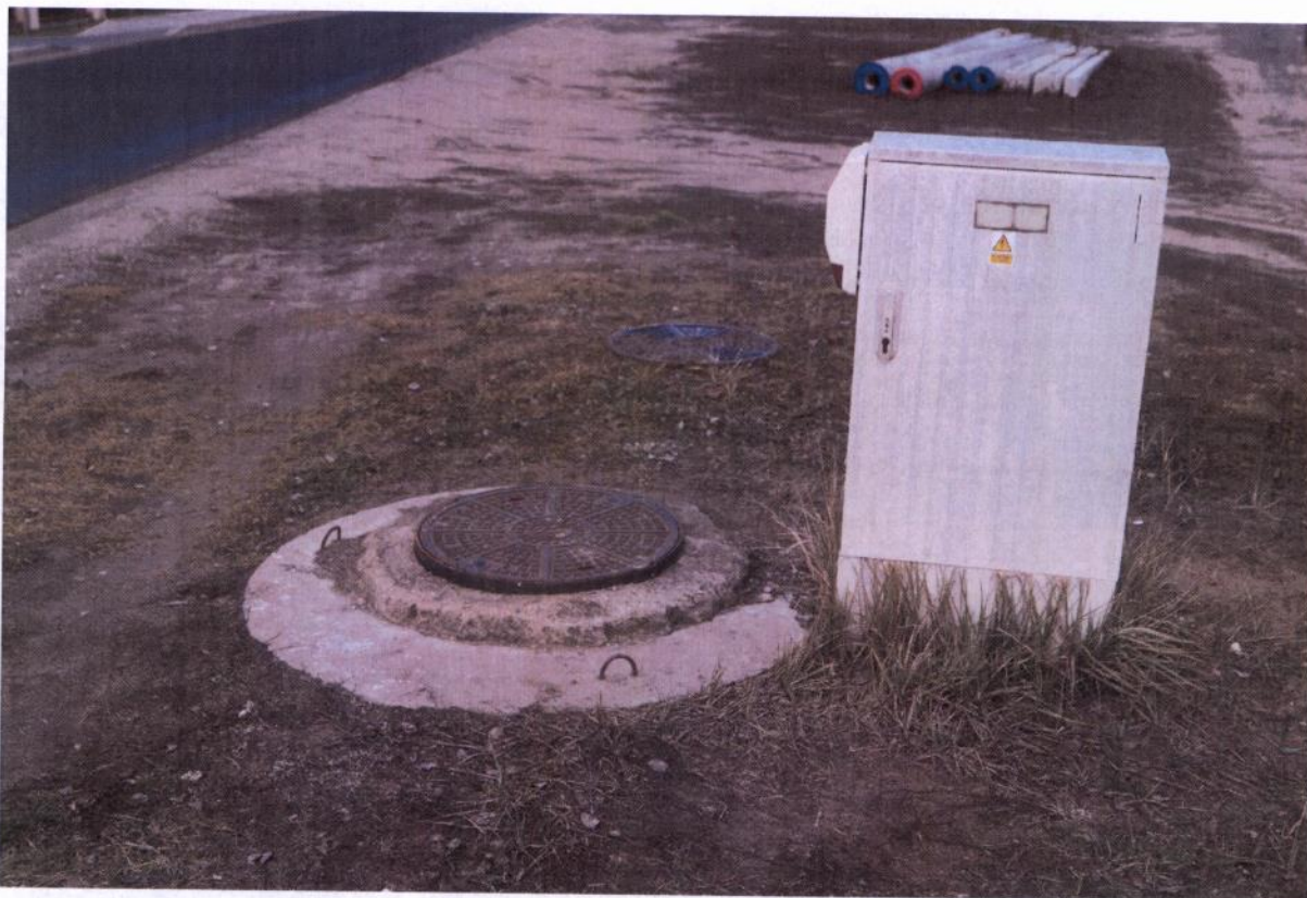
Rysunek 38. Przepompownia Nr 2 pompująca ścieki do oczyszczalni źródło: opracowanie własne
