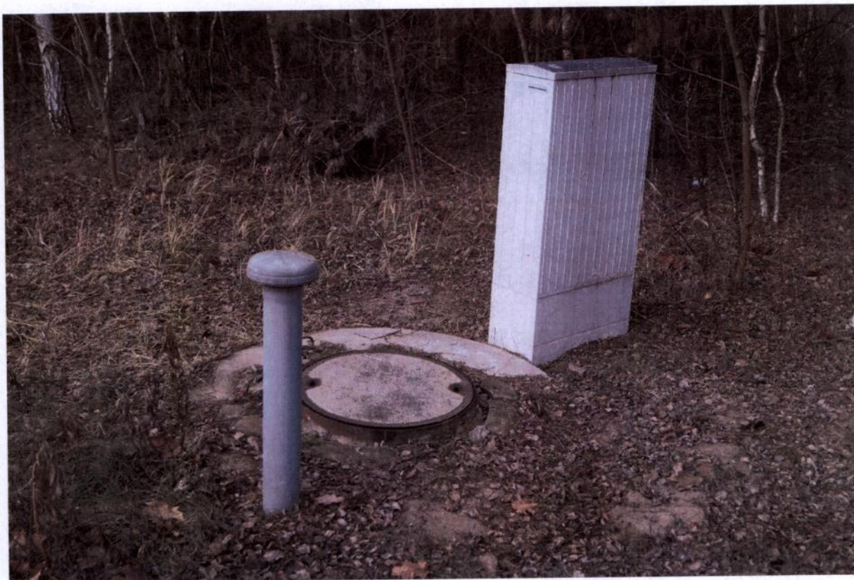
Rysunek 37. Przepompownia Nr 1. Znajduje się zaraz obok oczyszczalni ścieków w Modzerowie źródło: opracowanie własne
