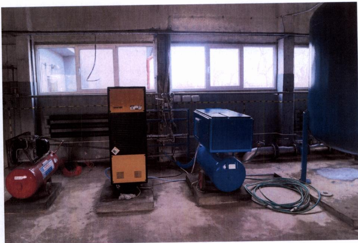
Rysunek 31. Stacja Uzdatniania Wody w Dębicach źródło: opracowanie własne
