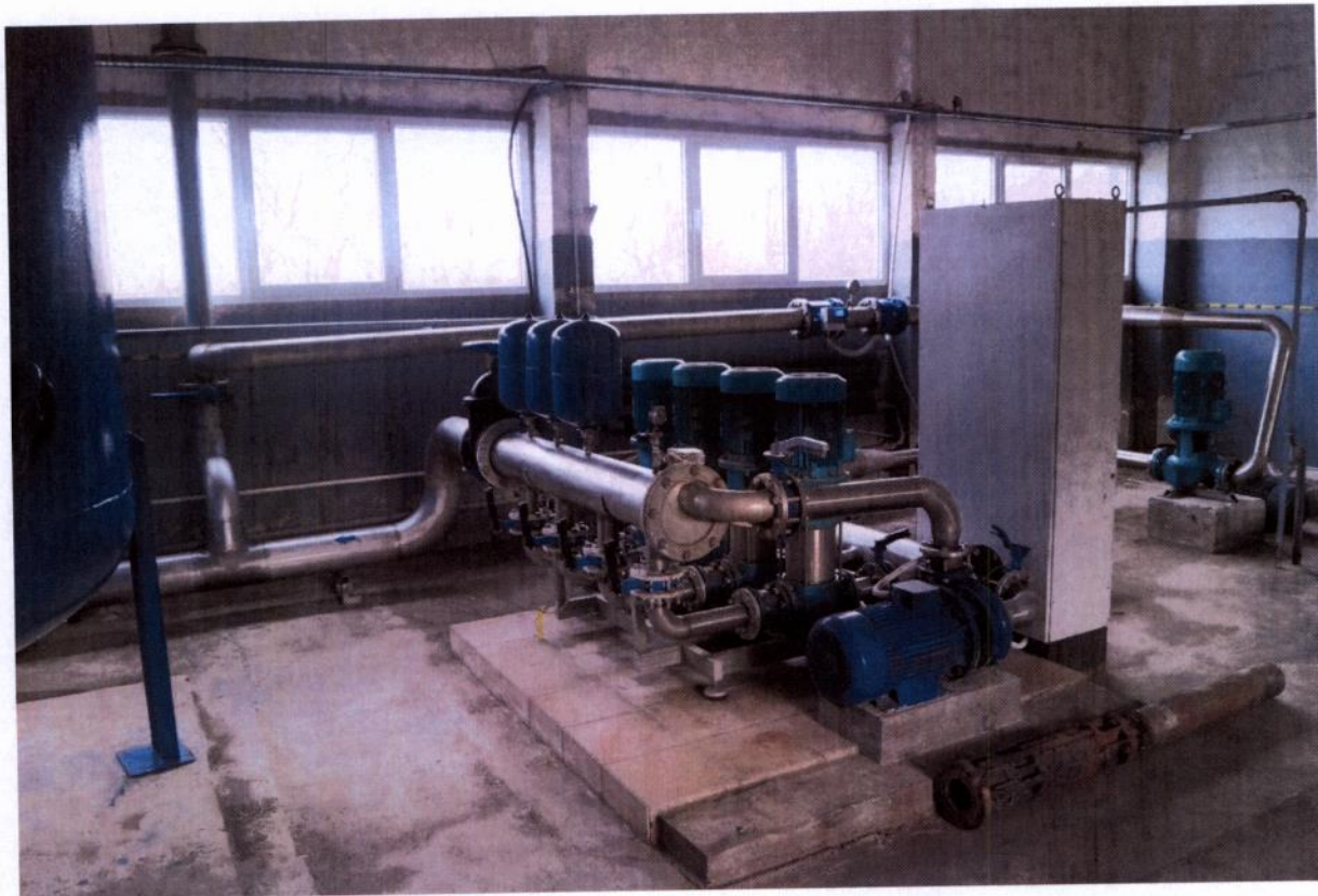
Rysunek 30. Stacja Uzdatniania Wody w Dębicach źródło: opracowanie własne
