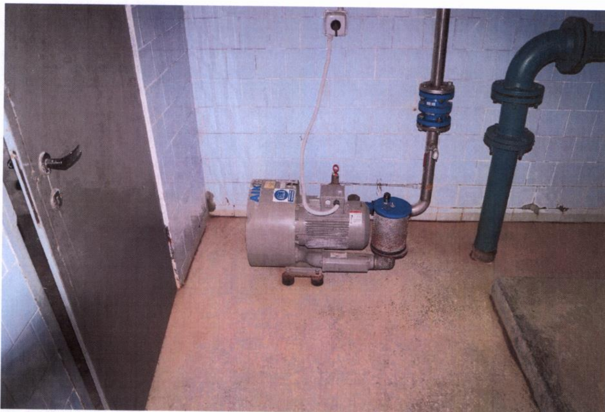
Rysunek 10. Stacja Uzdatniania Wody w Smólniku źródło: opracowanie własne
