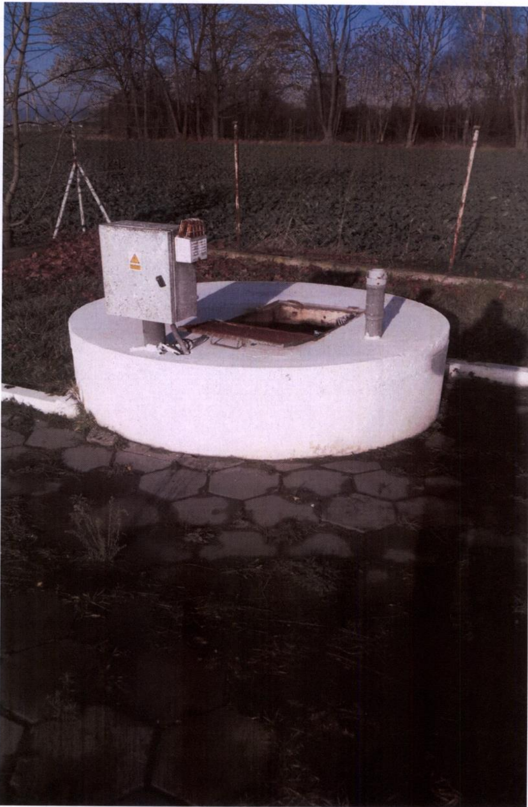
Rysunek 43. Przepompownia w Kruszynie obok plebanii źródło: Stacja Uzdatniania Wody Dębice
