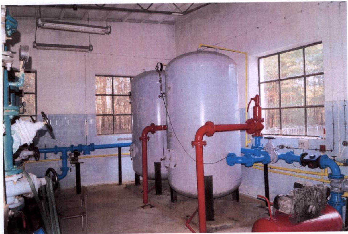
Rysunek 8. Stacja Uzdatniania Wody w Smólniku źródło: opracowanie własne
