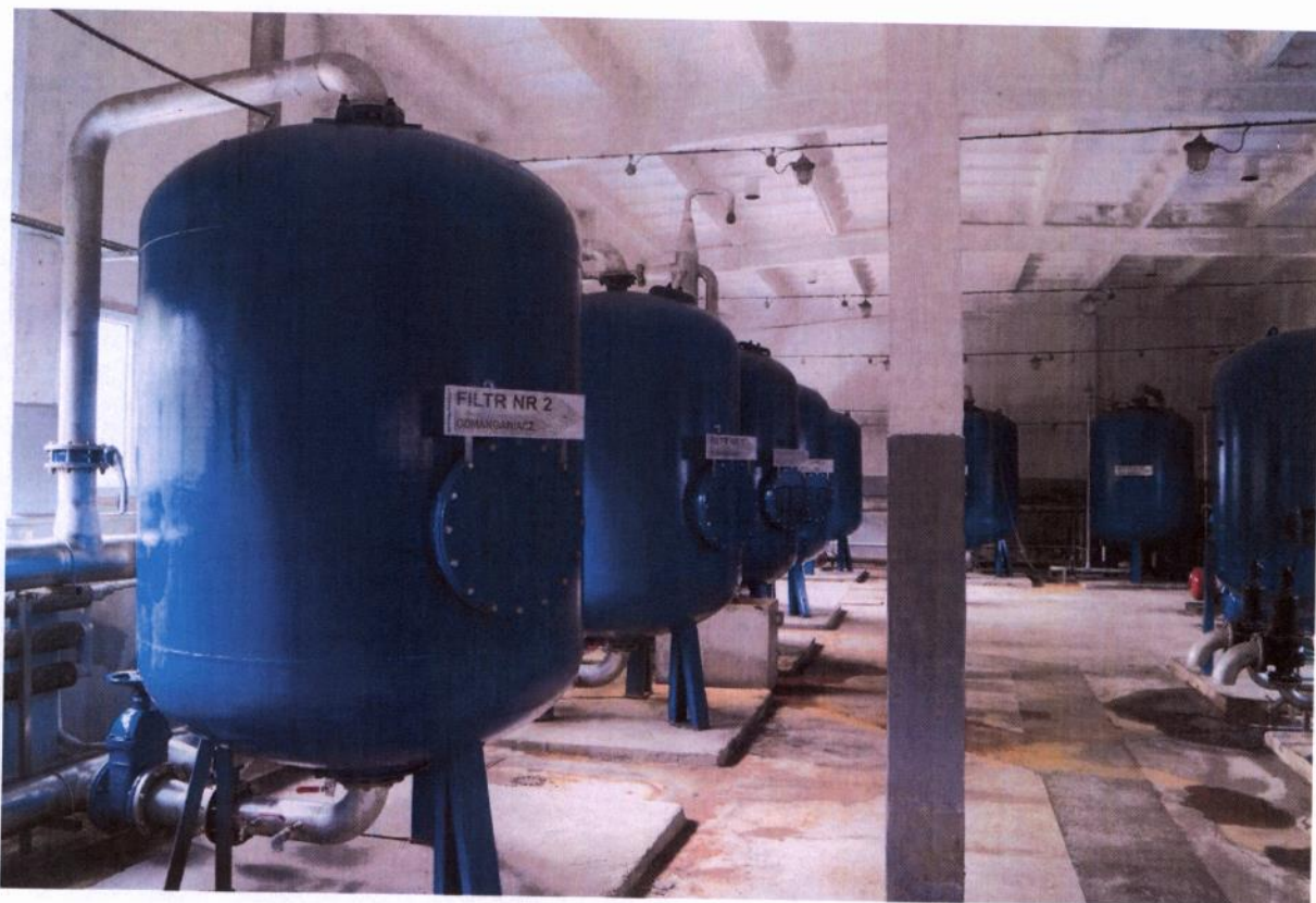
Rysunek 32. Stacja Uzdatniania Wody w Dębicach źródło: opracowanie własne
