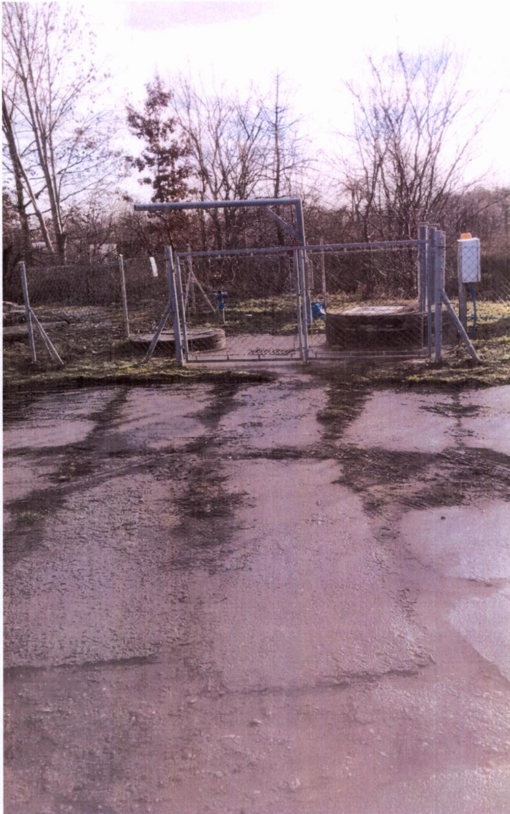
Rysunek 46. Przepompownia Świątosław źródło: Stacja Uzdatniania Wody Dębice
