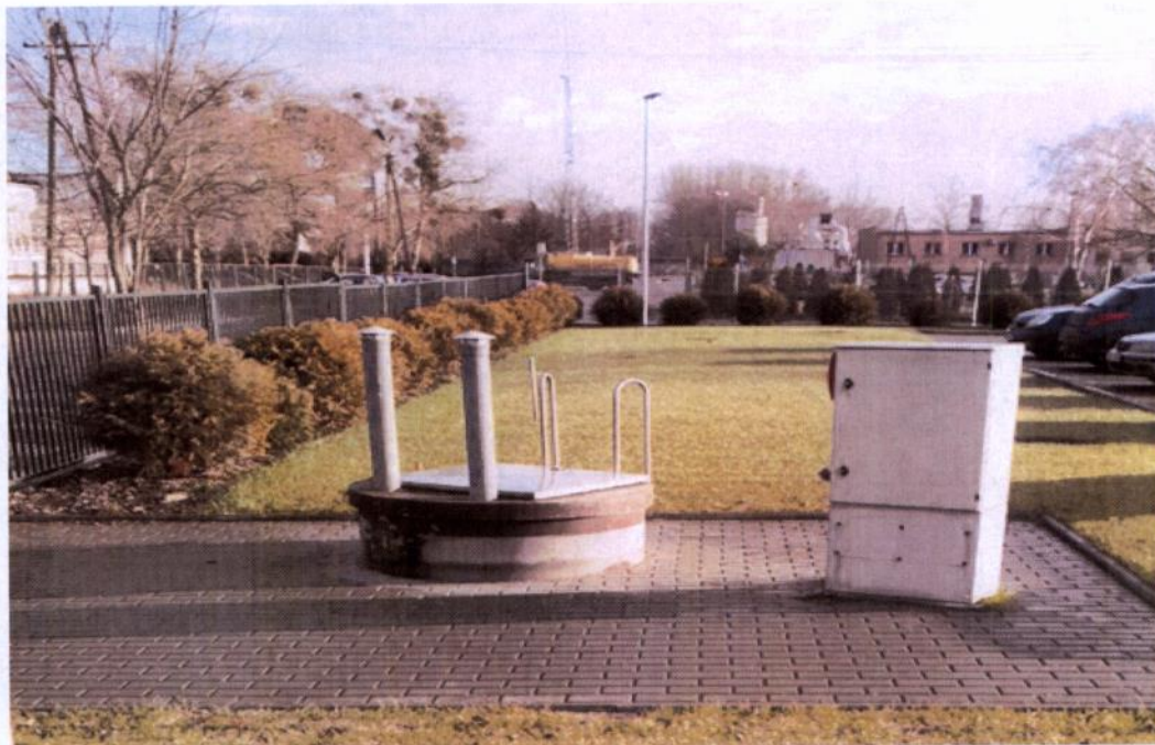
Rysunek 40. Przepompownia w Nowej Wsi źródło: Stacja Uzdatniania Wody Dębice
