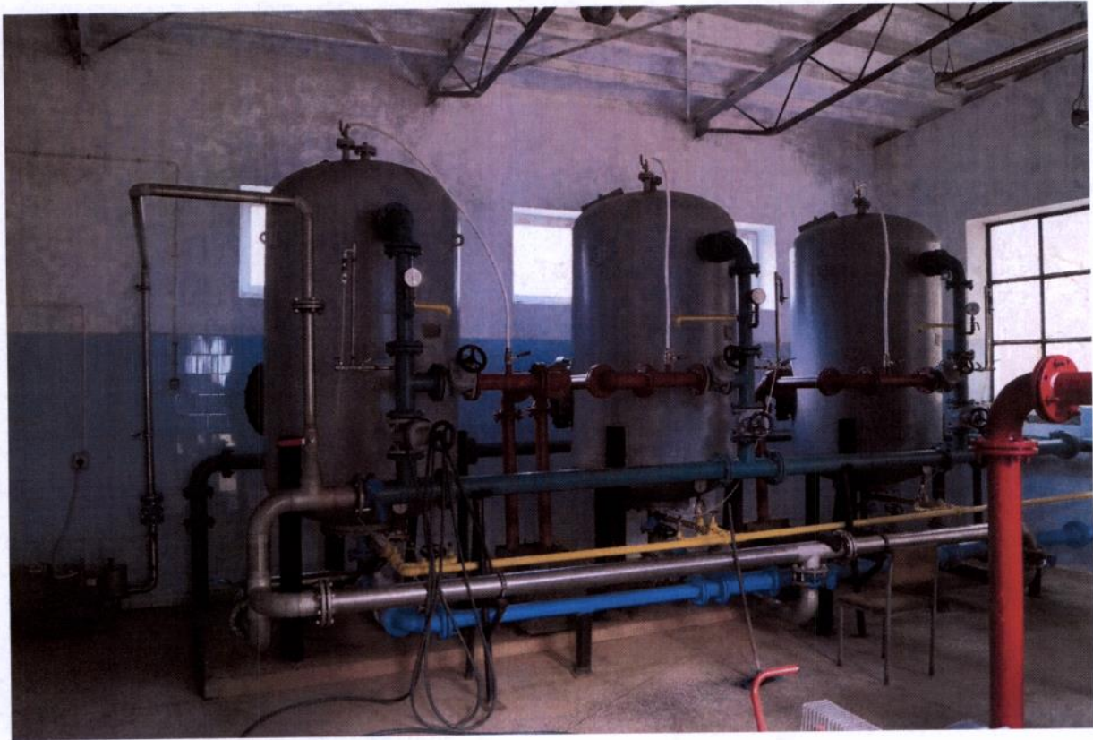
Rysunek 7. Stacja Uzdatniania Wody w Smólniku źródło: opracowanie własne
