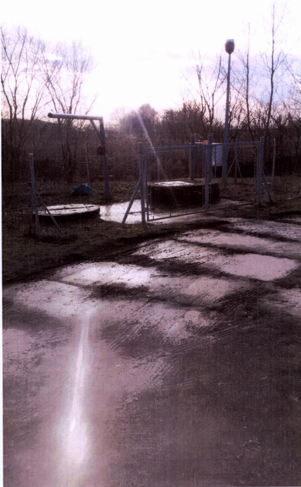
Rysunek 44. Przepompownia Świątosław źródło: Stacja Uzdatniania Wody Dębice
